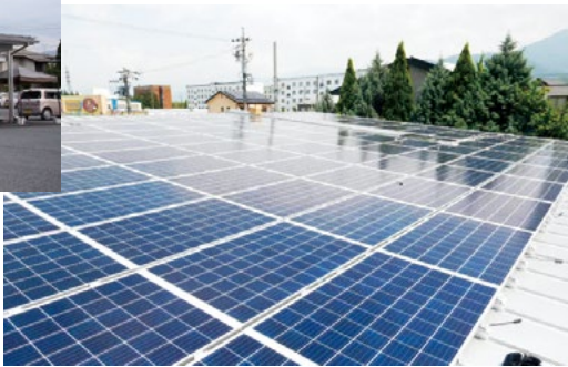
導入された出力24kWの太陽光パネル
